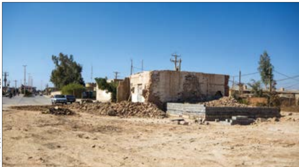
کارگاه تلمبه‌خانه دارخوین پس از تخریب
